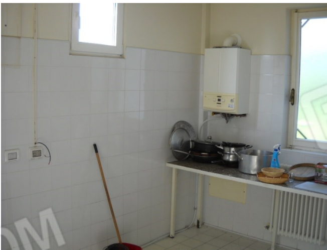
Locale commerciale retro con caldaia (sub.34)
