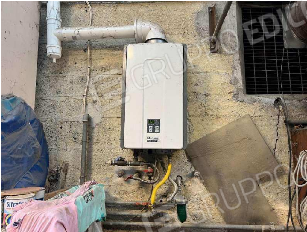
Figura 23 scaldabagno ubicato nella tettoia
