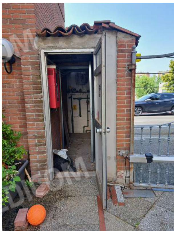
Figura 35- locale tecnico esterno
