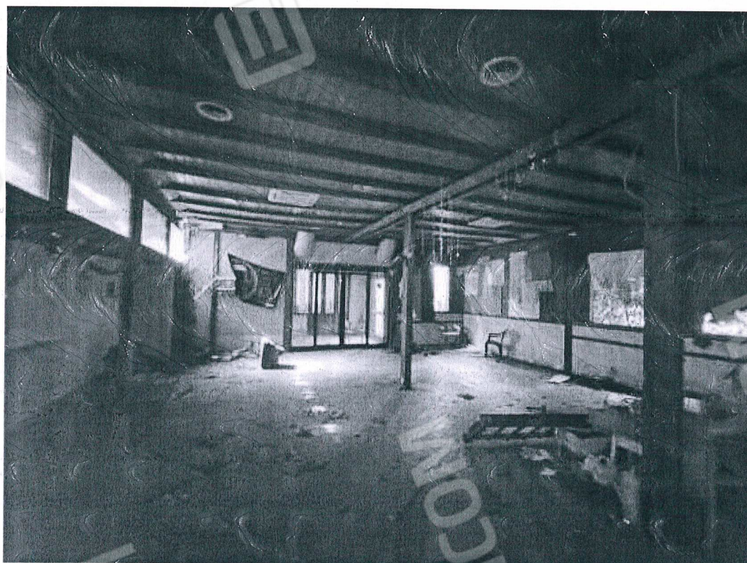
Vista interna locale dehor quota piano terra, non sanabile soggetto a demolizione
