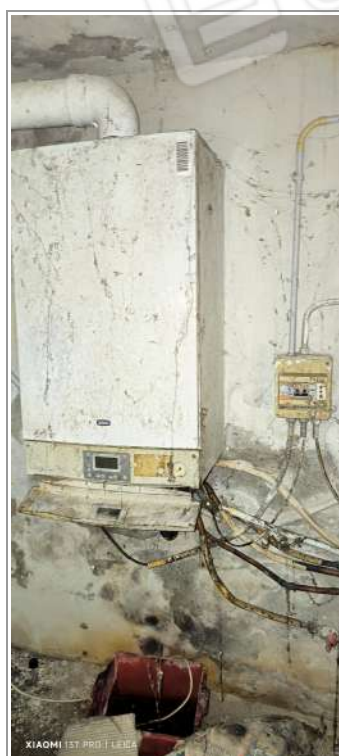
Foto n.27-28 :locaie tecnico e caldaia al PT
