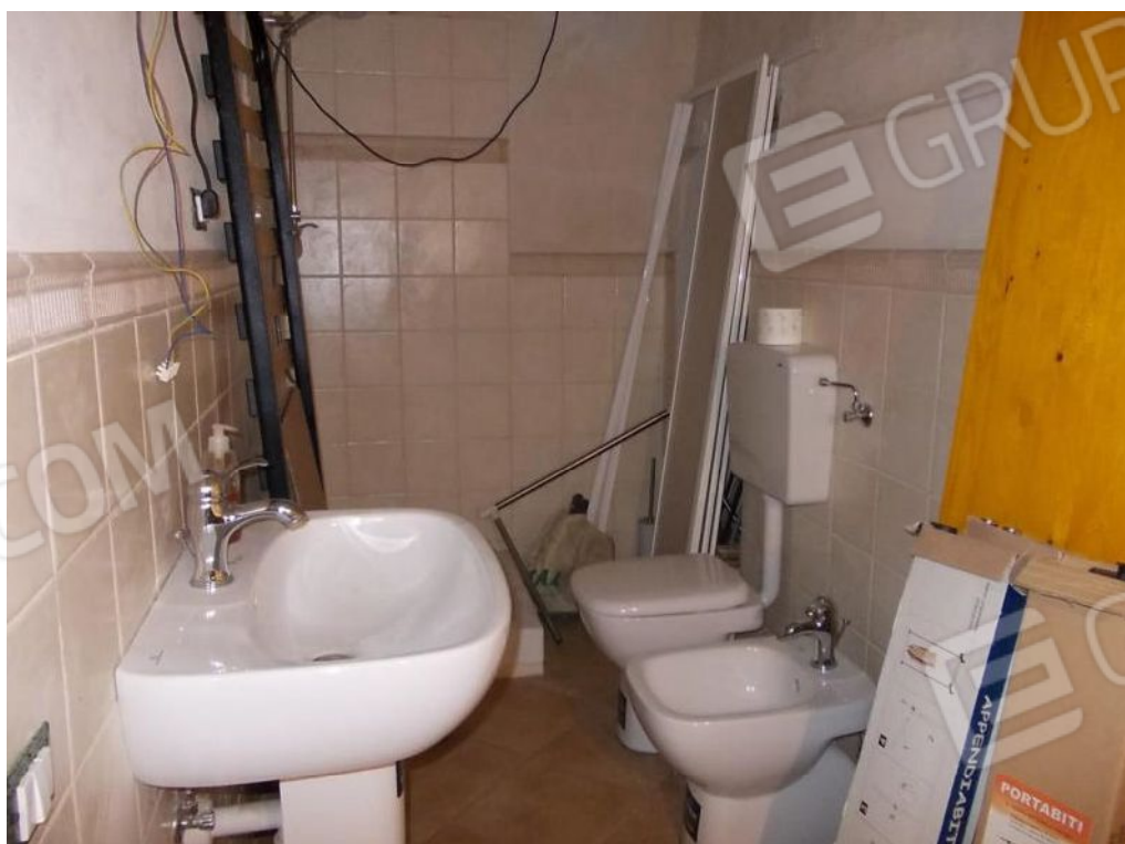
Foto 18 Bagno abitazione mapp.336 sub.2 p.t.
