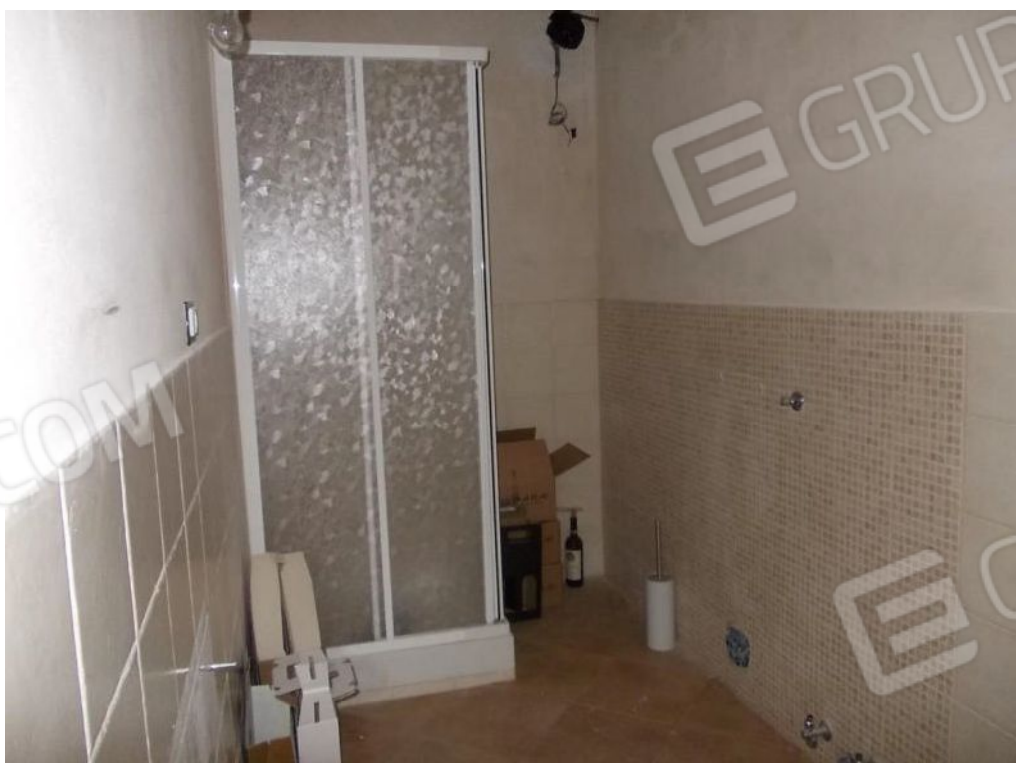
Foto 16 Bagno abitazione mapp.336 sub.2 p.t.
