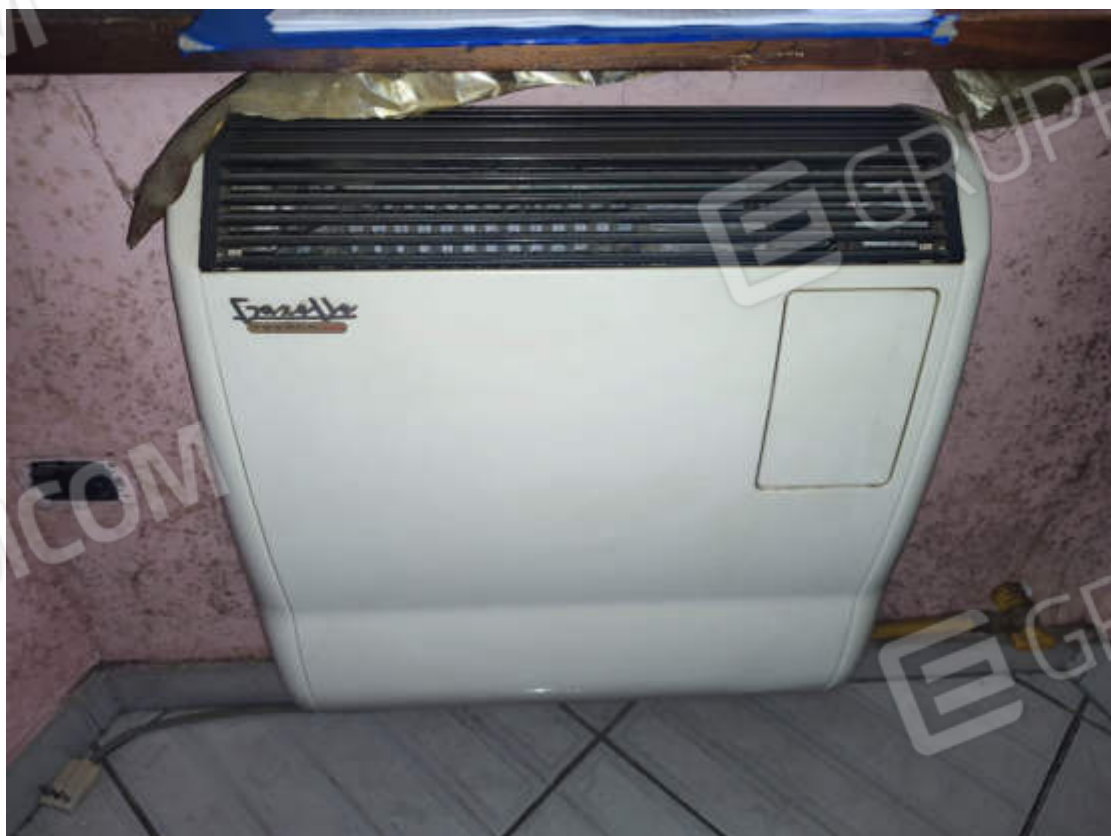
Vista ventilconvettore a gas locale camera letto quota piano secondo ( dismesso )
