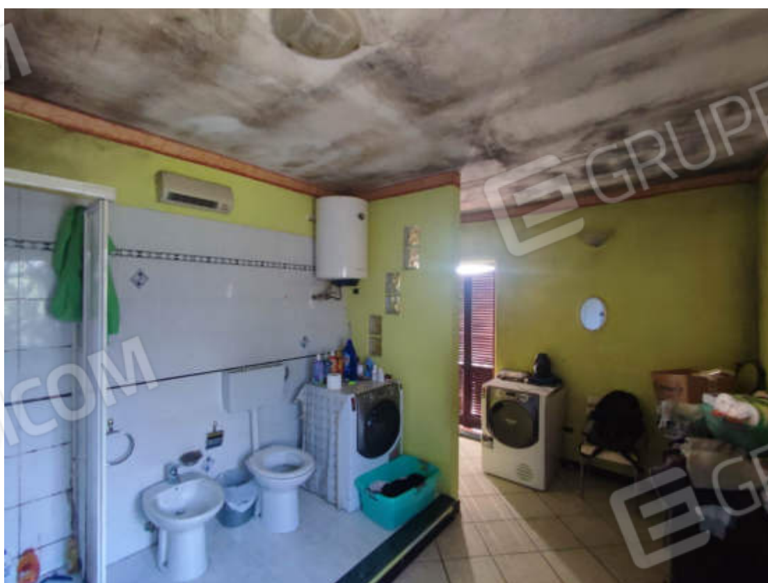
Vista interna locale bagno quota piano primo Vista particolare ammaloramento intradosso solaio per presenza di muffa
