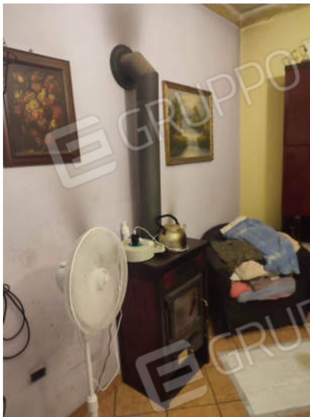
Vista stufa pellet locale soggiorno quota piano terra
