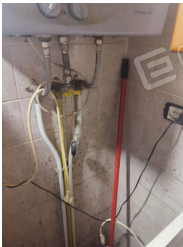
Vista impianto distribuzione gas metano
