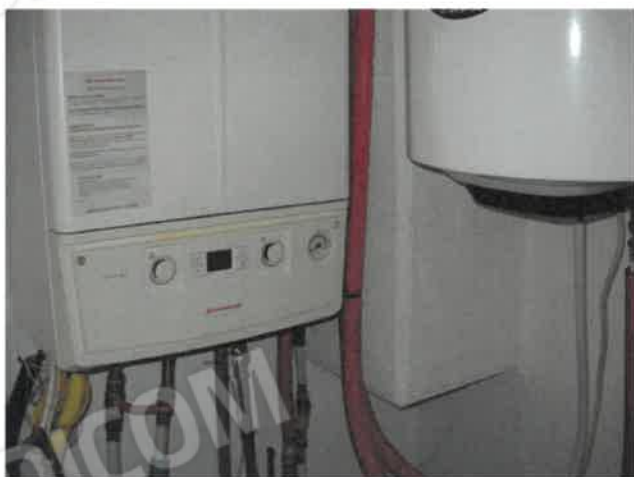
Caldaia alloggio piano terra Lotto 1
