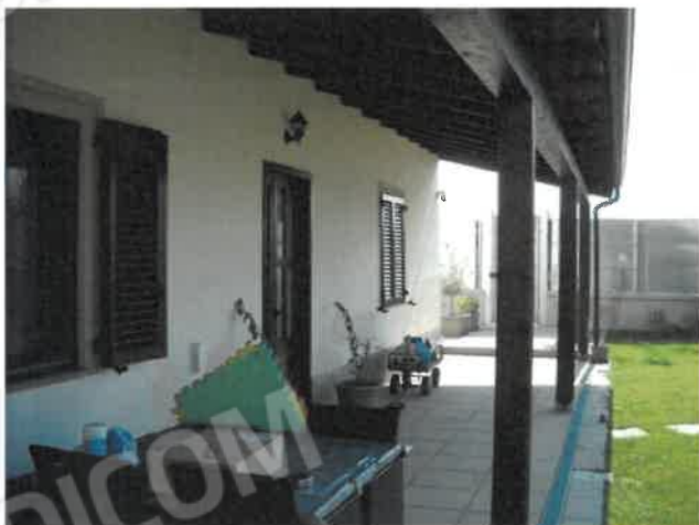
Porticato non autorizzato piano terra Lotto 1
