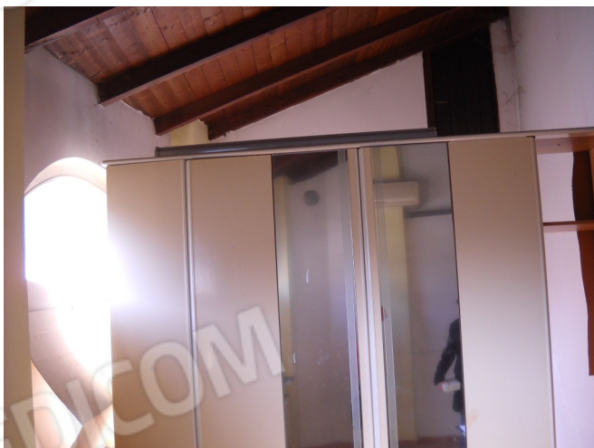
Soffitto piano primo
