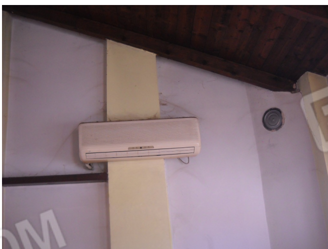
Pompa di calore piano primo
