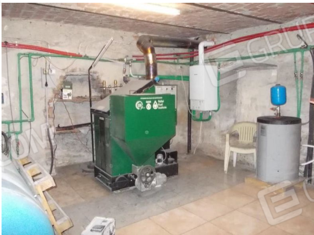
Foto 20 Centrale termica abitazione mapp.336 sub.2 p.t.
