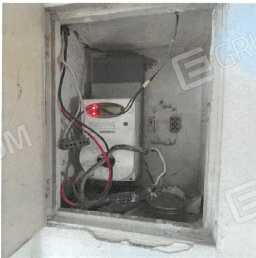
Vista particolare contatore luce – forza
