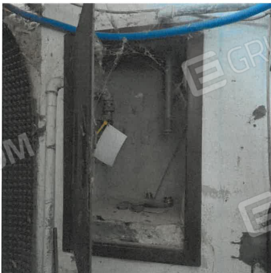
Vista particolare contatore impianto gas – metano
