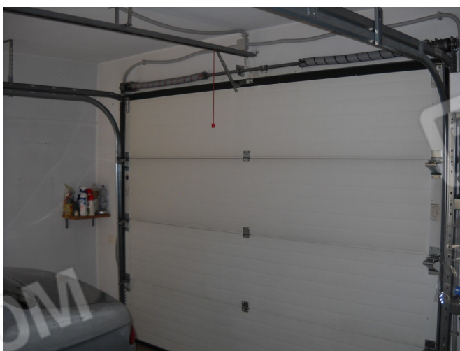
Baculante motorizzato rimessa piano terreno
