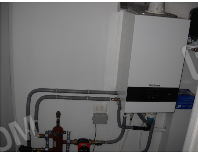
Caldaia piano secondo mansardato
