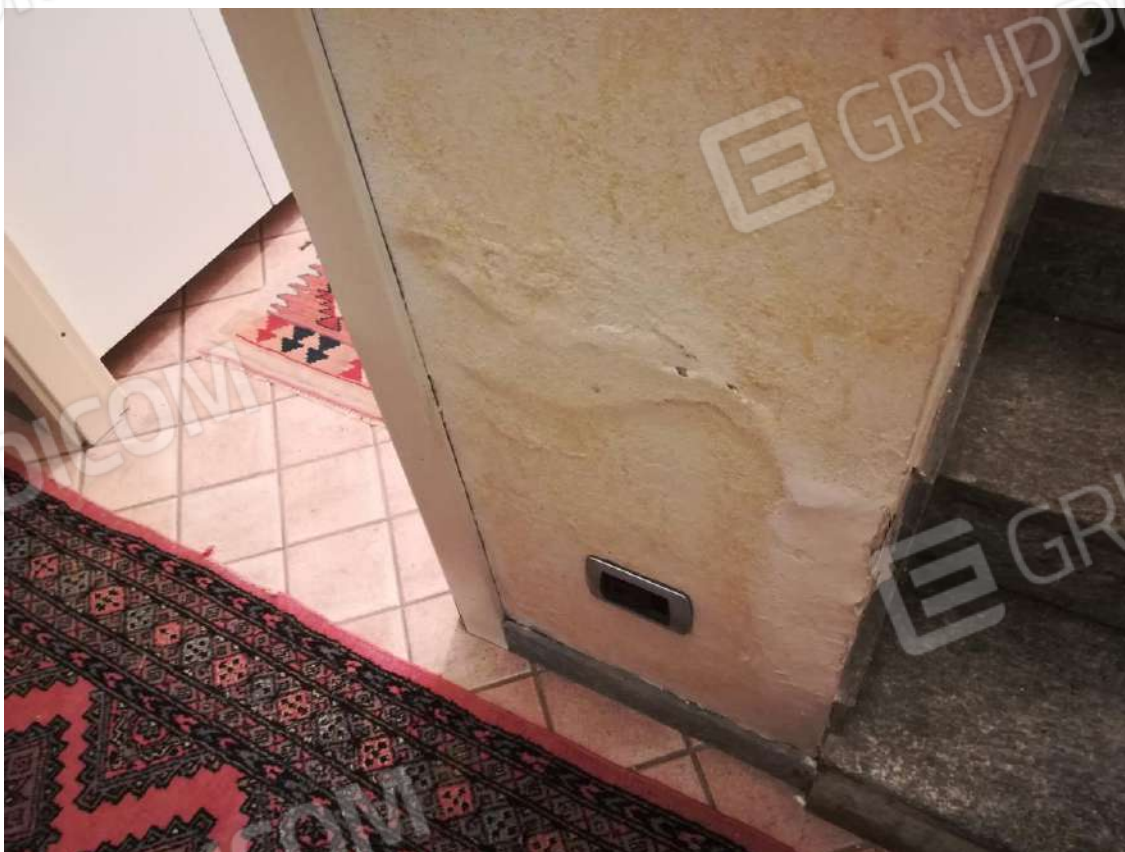
Foto n. 29_Umidità al piano interrato
