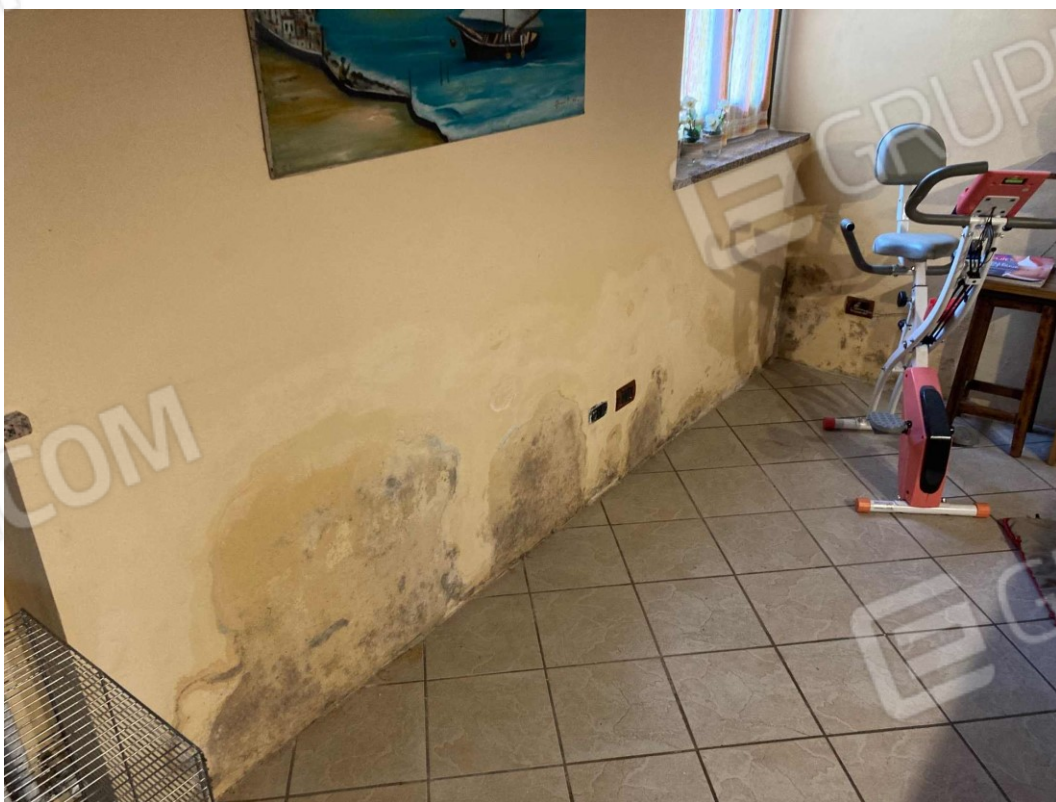
Foto 6 – Umidità di risalita al PT
