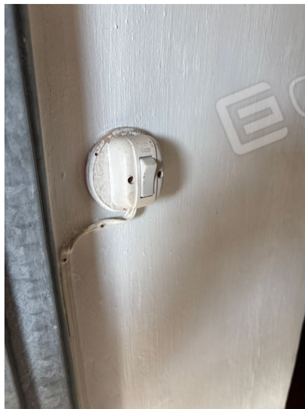
Figura A.20: P.1. (mappale 202), interruttore elettrico, con cavo a doppino.
