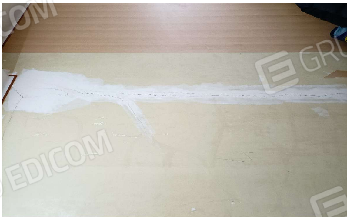
Fessurazioni intonaci pareti verticali vano scala foto 26-27-28)
