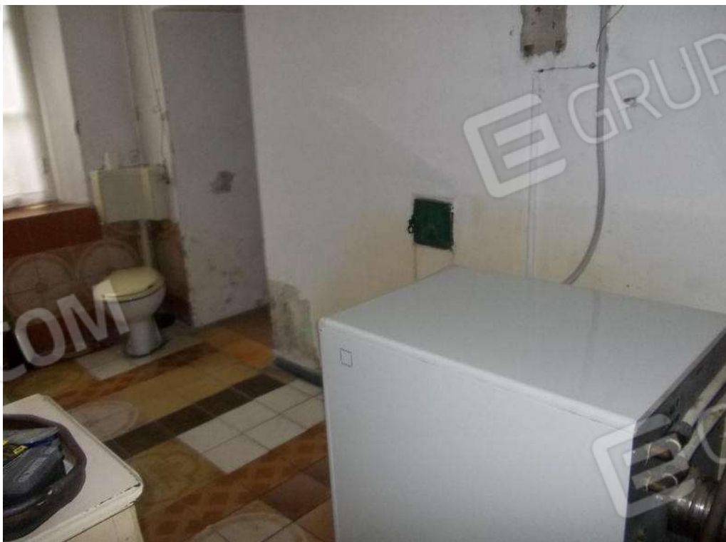
Foto 16 Locale caldaia abitazione piano terra
