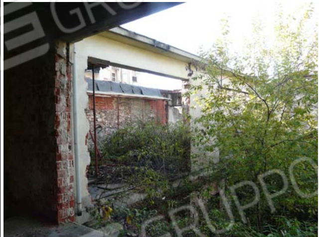
Foto 26 porzione sud magazzino sub 11 privo di solaio ,
