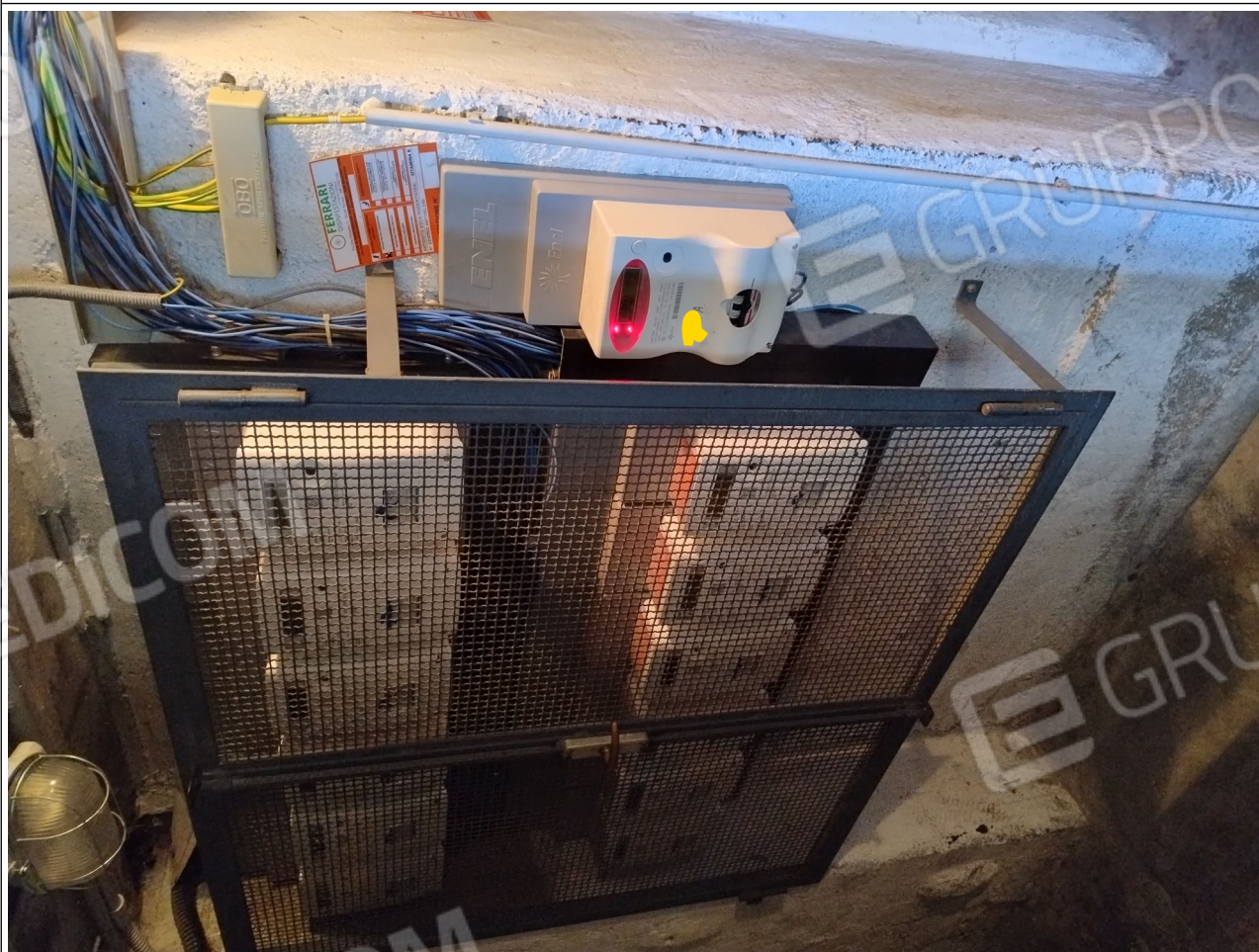
Foto12: contatore energia elettrica.
