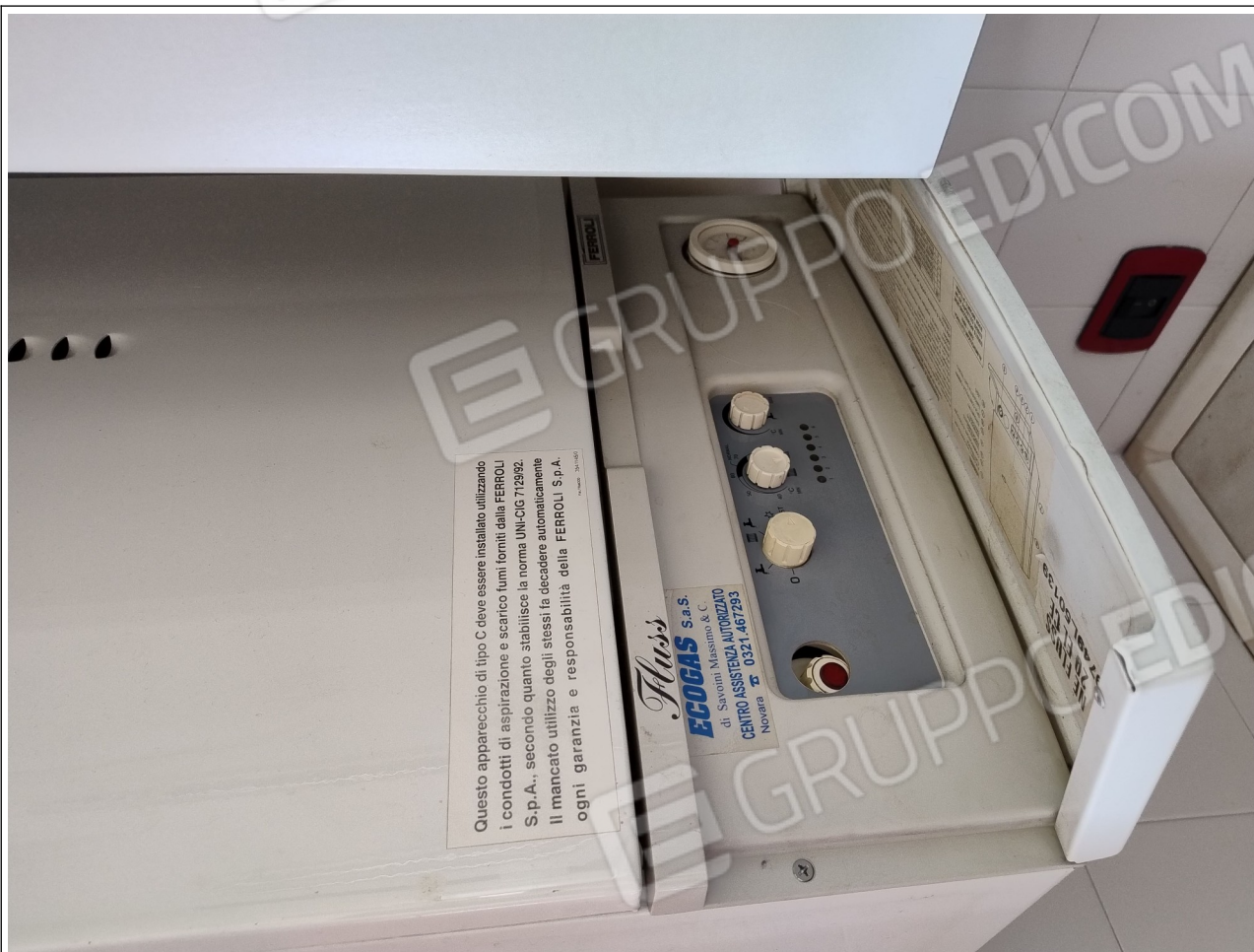
Foto11: vista appartamento – caldaia.
