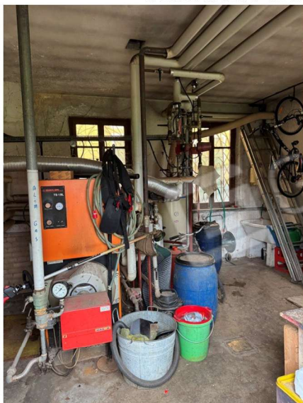
Vista centrale termica
