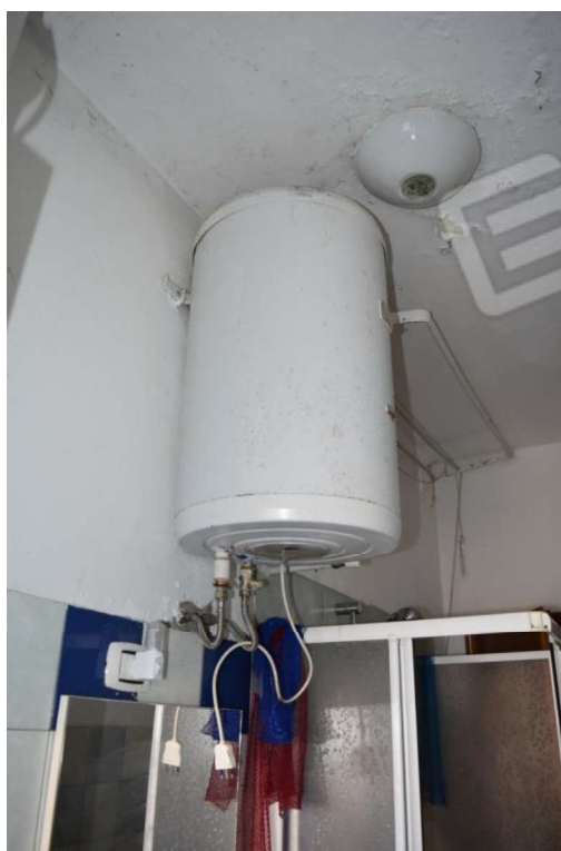
Foto 27: Servizio igienico, particolare boiler elettrico
