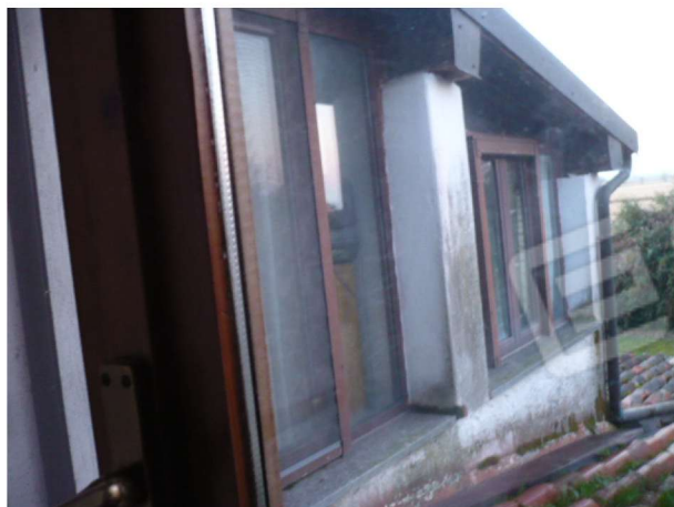
23 – Vista ampliamento abusivo
