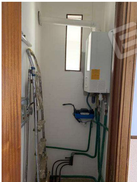
Foto 37: RIPOSTIGLIO CON CALDAIA
