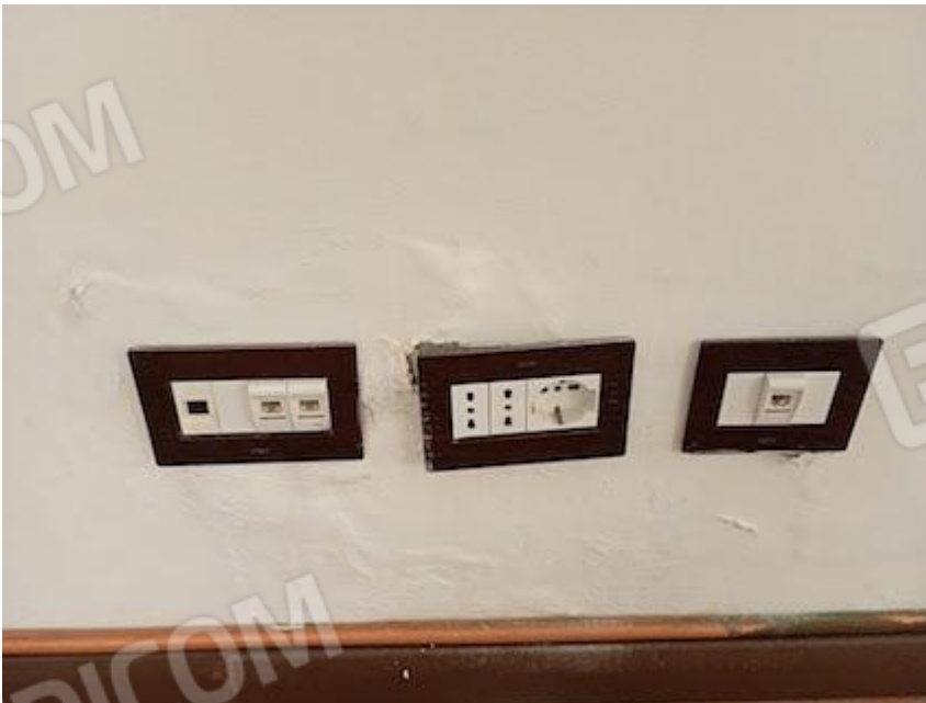
Particolare impianto elettrico
