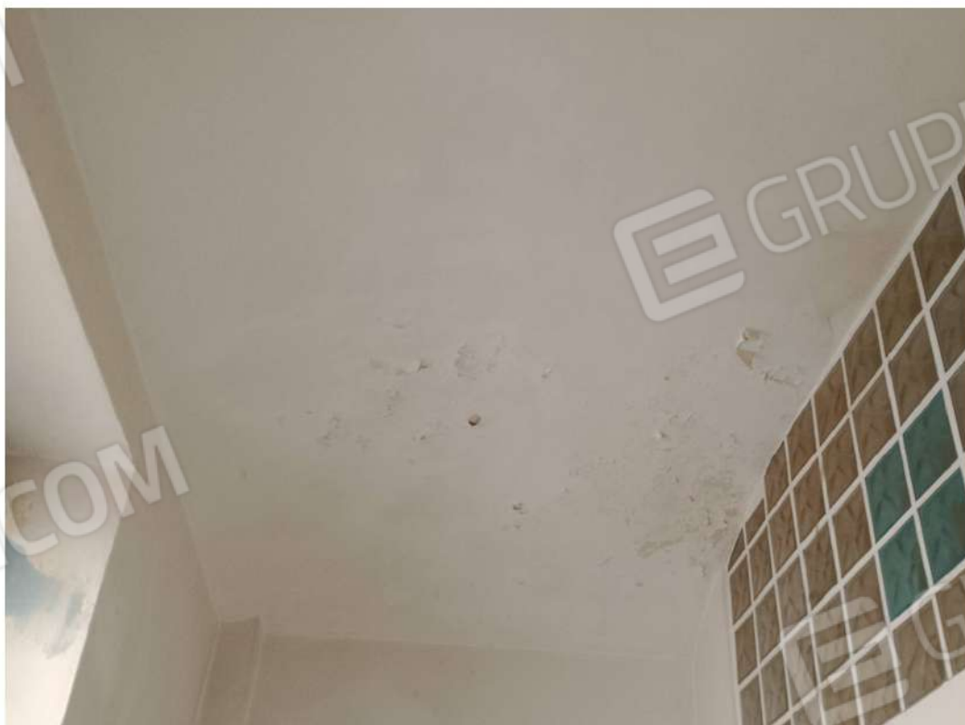
Foto n. 11: soffitto bagno interessato da infiltrazioni
