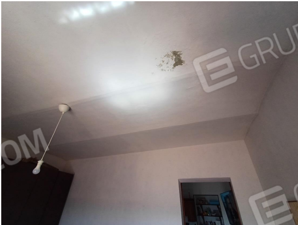
Foto 45 – Infiltrazioni sul soffitto
