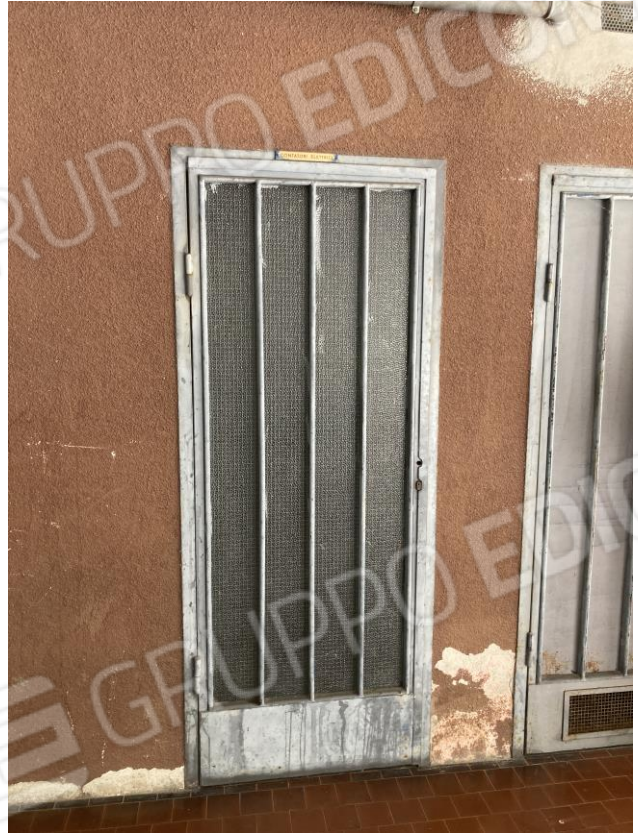
LOCALE CONTATORI ELETTRICI
