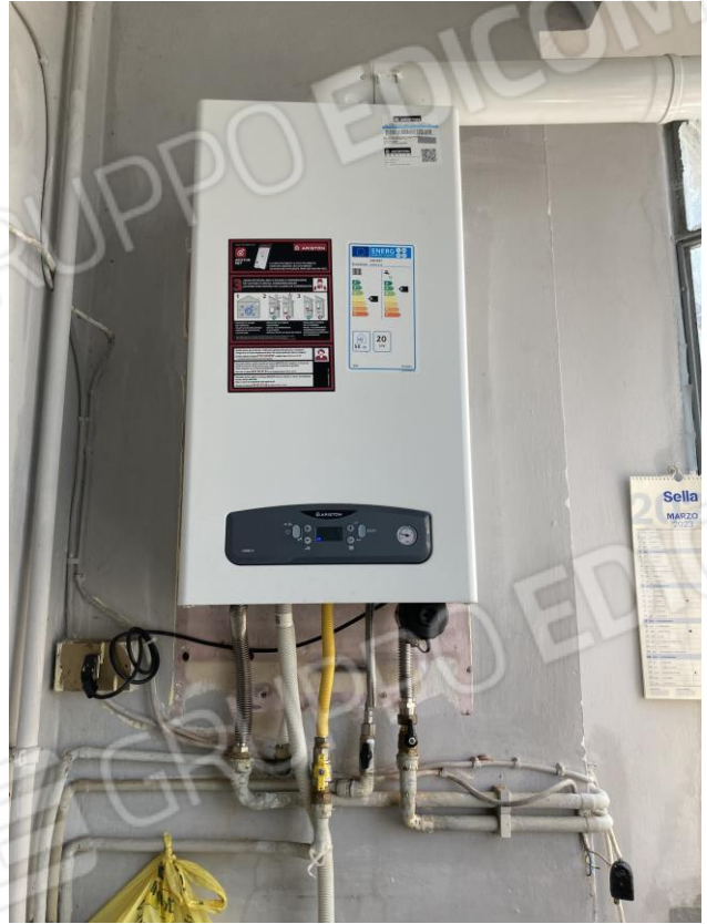
CALDAIA AUTONOMA A GAS METANO
