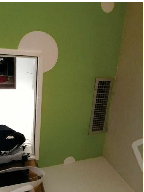
Particolare bocchetta di ventilazione Camera 1 imp. riscaldamento ad aria dell'alloggio
