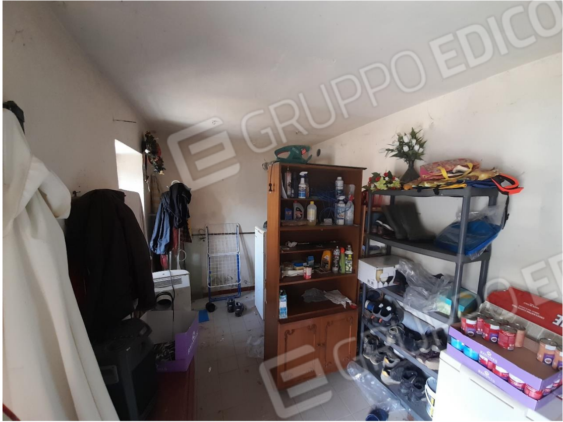
FOTO 16 – Centrale termica al piano terreno
