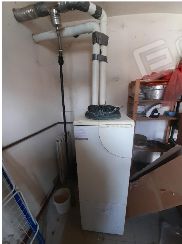
FOTO 17 – Caldaia a gas
