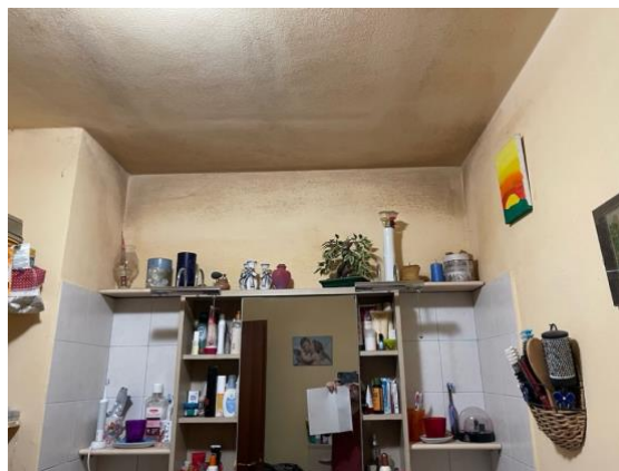
Immagine 35: Foto interni del fabbricato civile, piano primo, soffitto antibagno.
