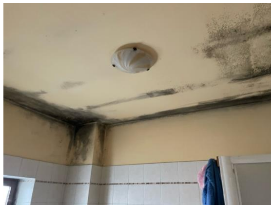
Immagine 38: Foto interni del fabbricato civile, piano primo, soffitto bagno.
