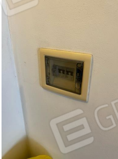
Immagine 44: Foto particolare quadro elettrico piano primo.
