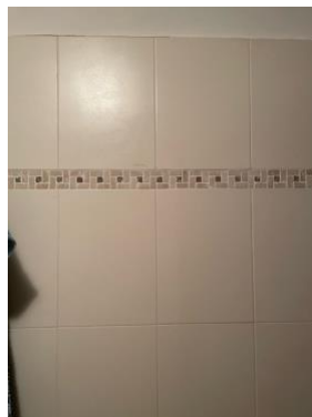
Immagine 26: Foto interni del fabbricato civile, piano terreno, piastrellature bagno.
