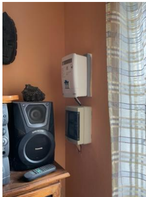
Immagine 45: Foto particolare quadro elettrico piano terreno e contatore elettrico generale.
