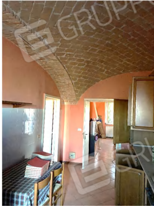
CUCINA (SUB. 5) soffitto
