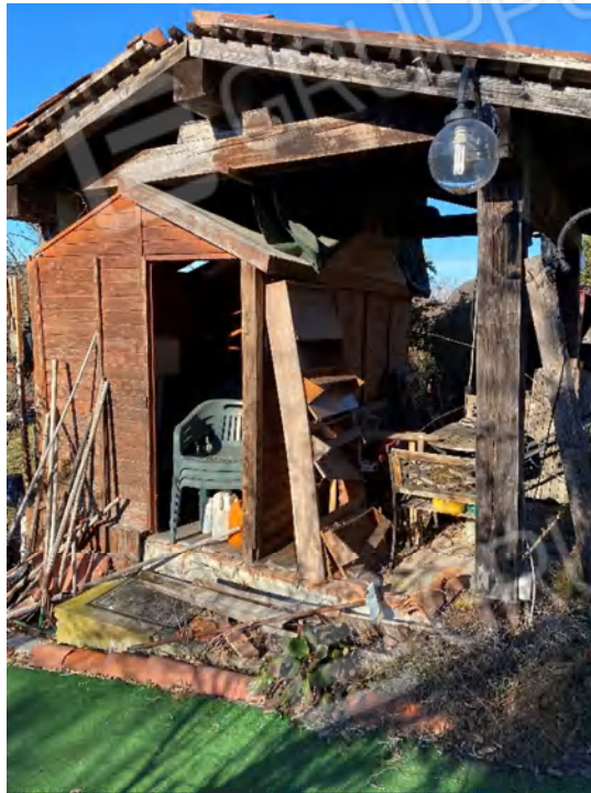
TETTOIA E CASETTA SOTTOSTANTE IN LEGNO SU BASAMENTO priva di concessione ed accatastamento
