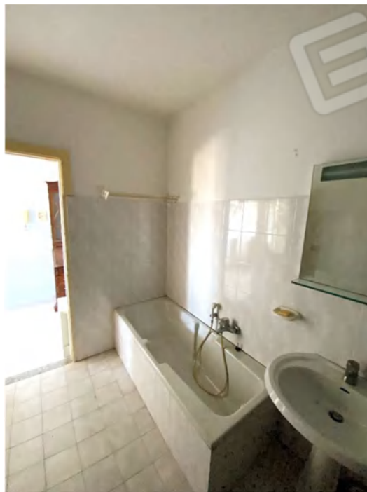
BAGNO (SUB 7) soffitto
