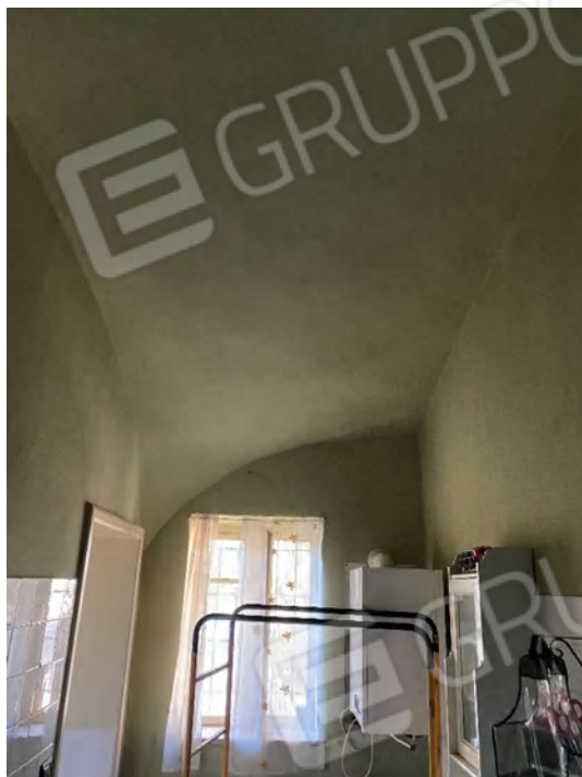
BAGNO "A,, (SUB. 5) soffitto
