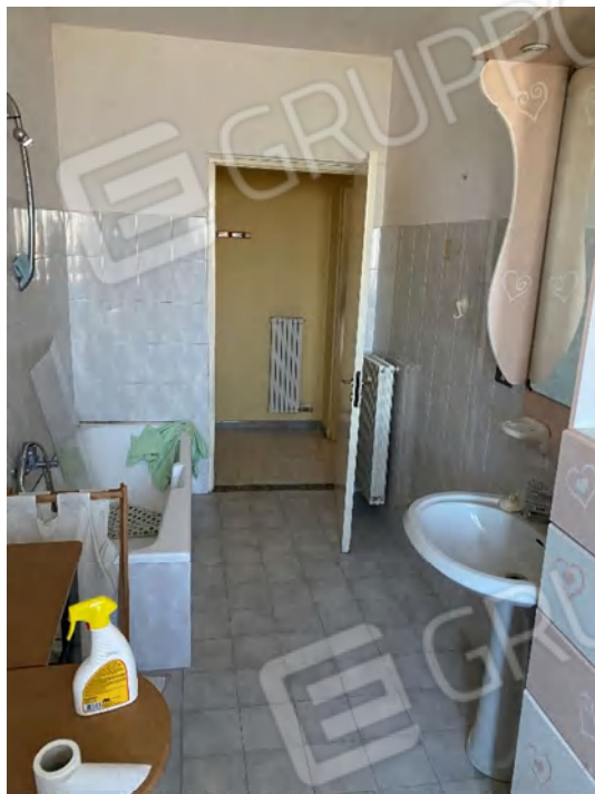
BAGNO (SUB 6) soffitto
