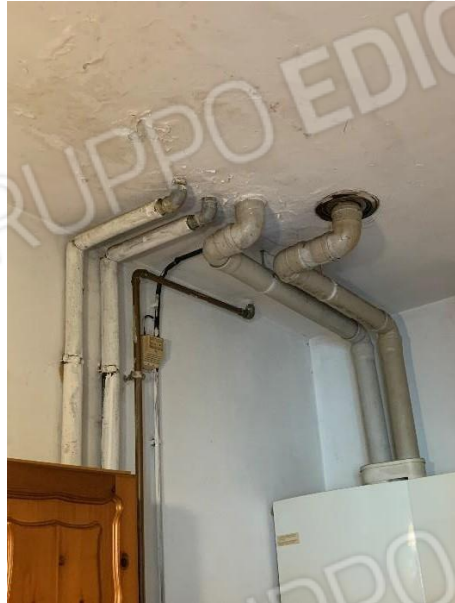
INFILTRAZIONI DA COPERTURA
