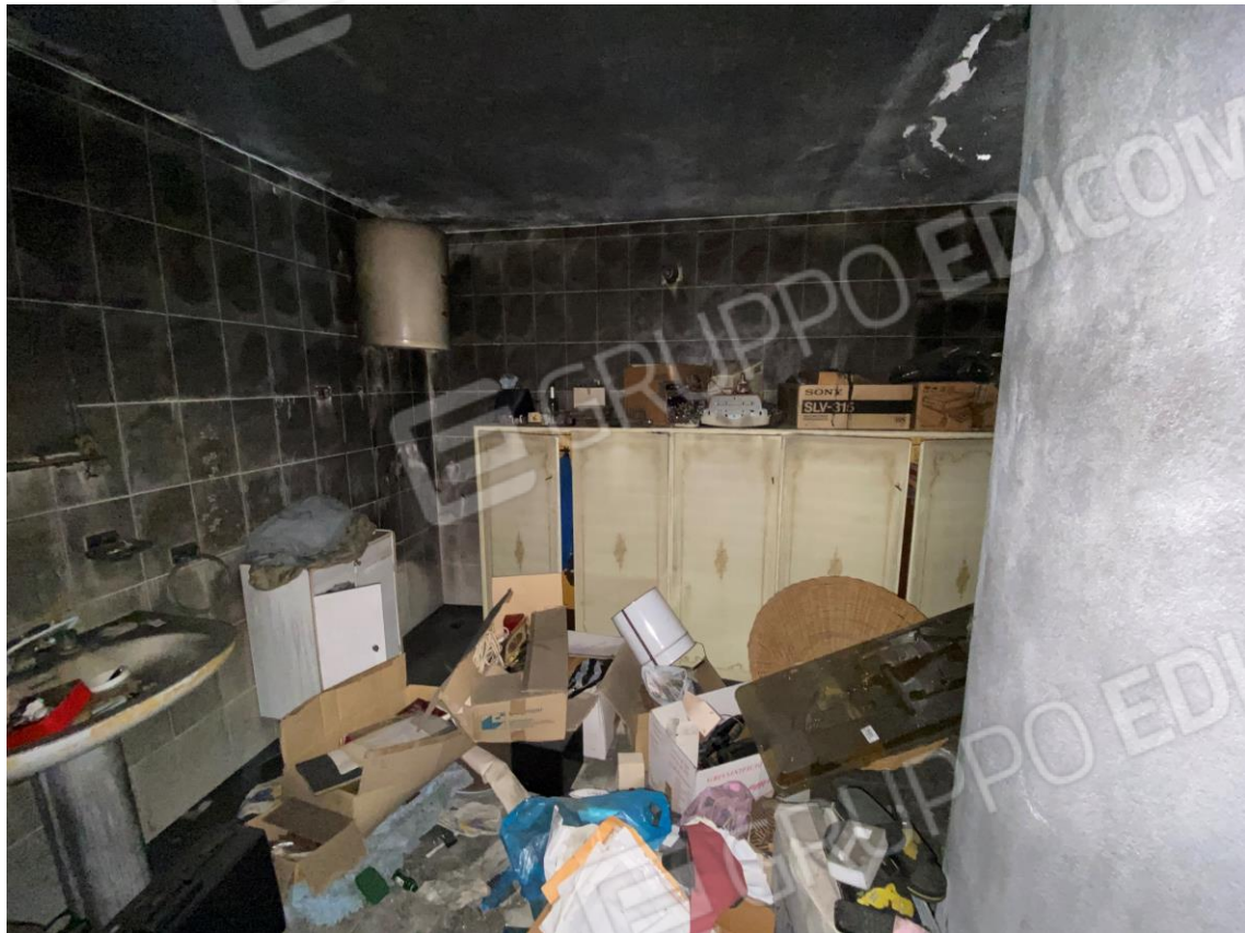
FOTO 19 : VISTA D'INSIEME BAGNO AL PIANO SECONDO
