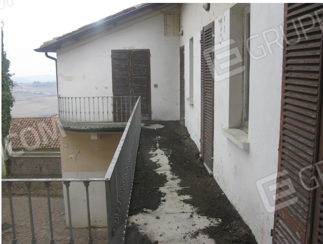
Foto 32 – Balcone piano primo
