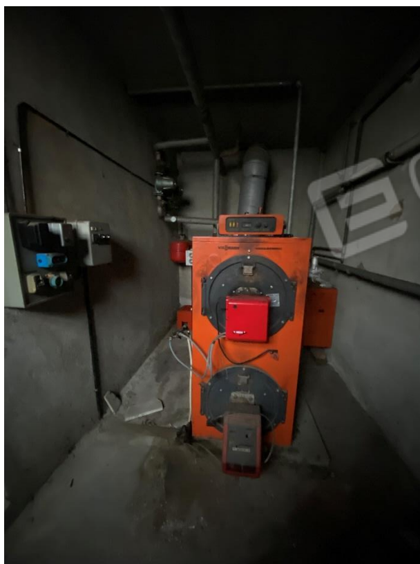
FOTO 24: VISTA INTERNA CENTRALE TERMICA PIANO SEMINTERRATO
