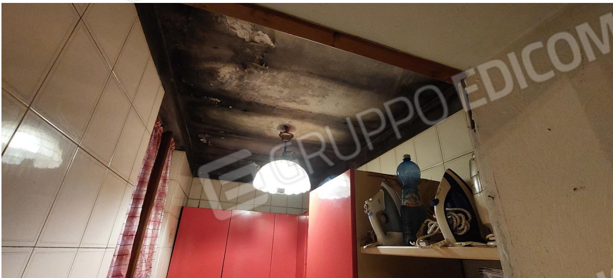
FOTO 10 – Soffitto cucinino piano terreno
