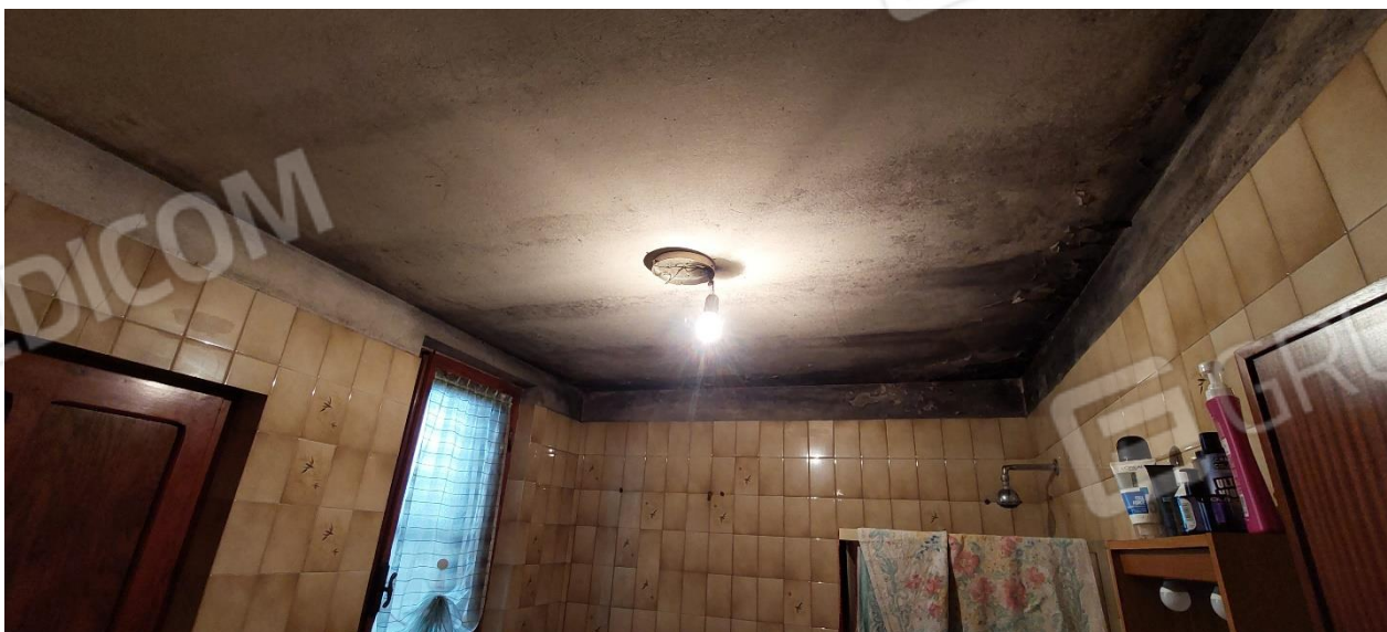
FOTO 15 – Soffitto bagno piano terreno
