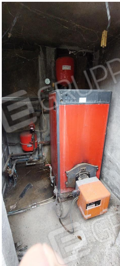
FOTO 19 – Bruciatore a gasolio
