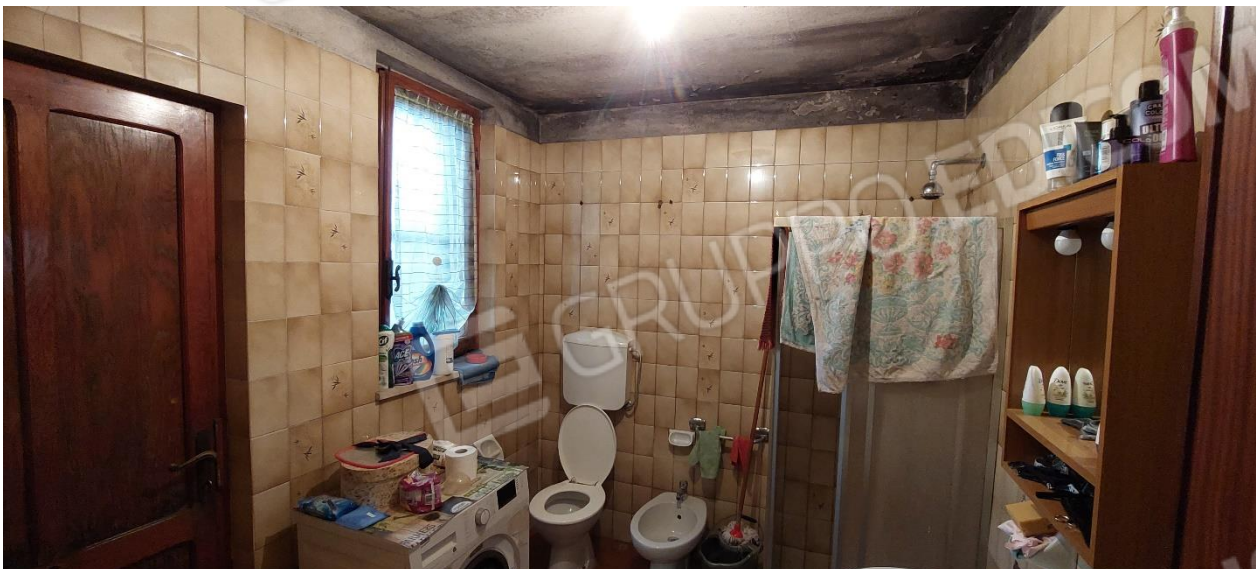
FOTO 13 – Bagno piano terreno
