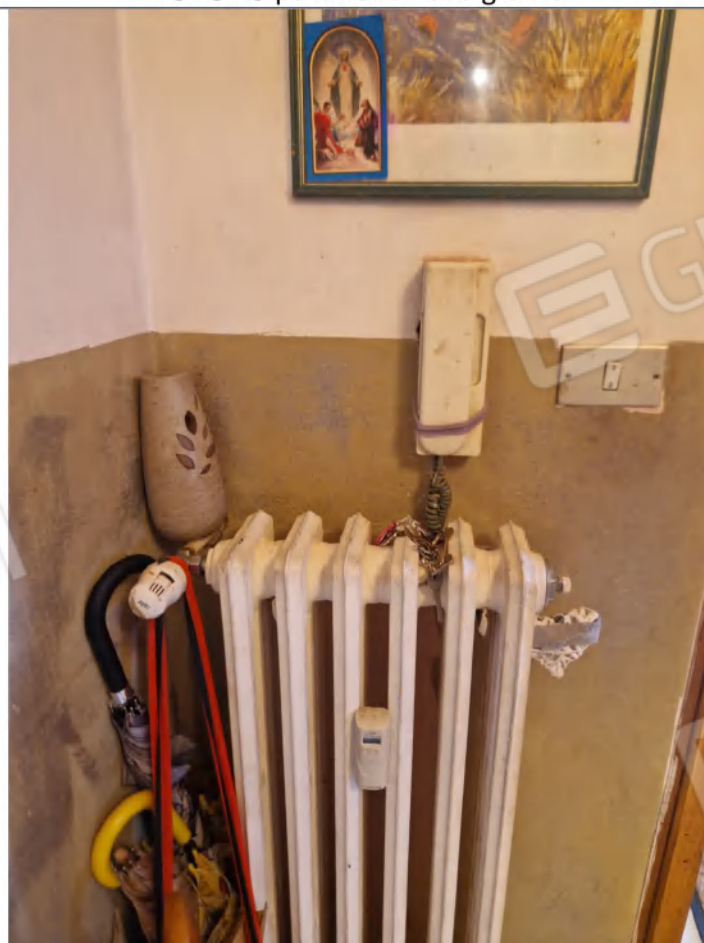
FOTO 20 radiatori con termovalvole
