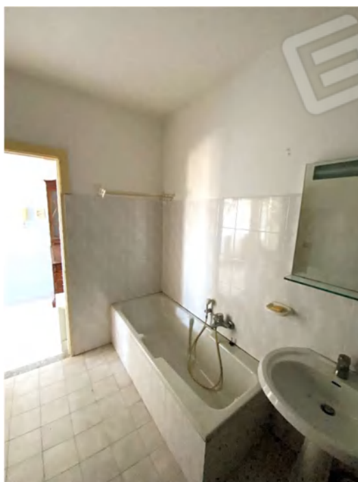
BAGNO (SUB 7) soffitto
