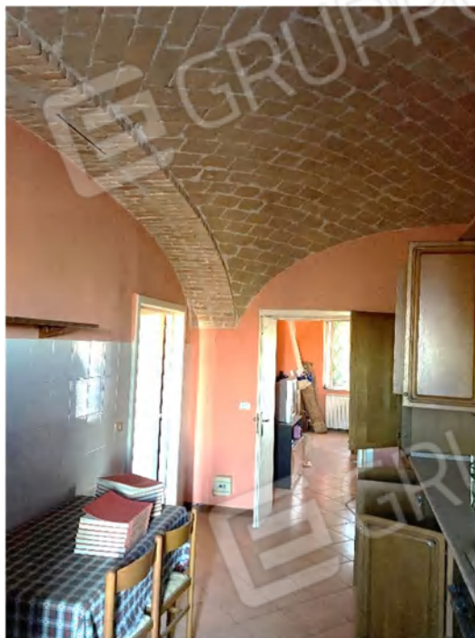
CUCINA (SUB. 5) soffitto
