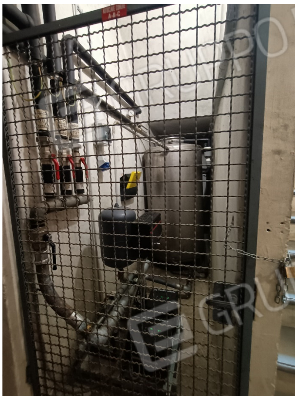
Generatore impianto centralizzato al piano seminterrato
