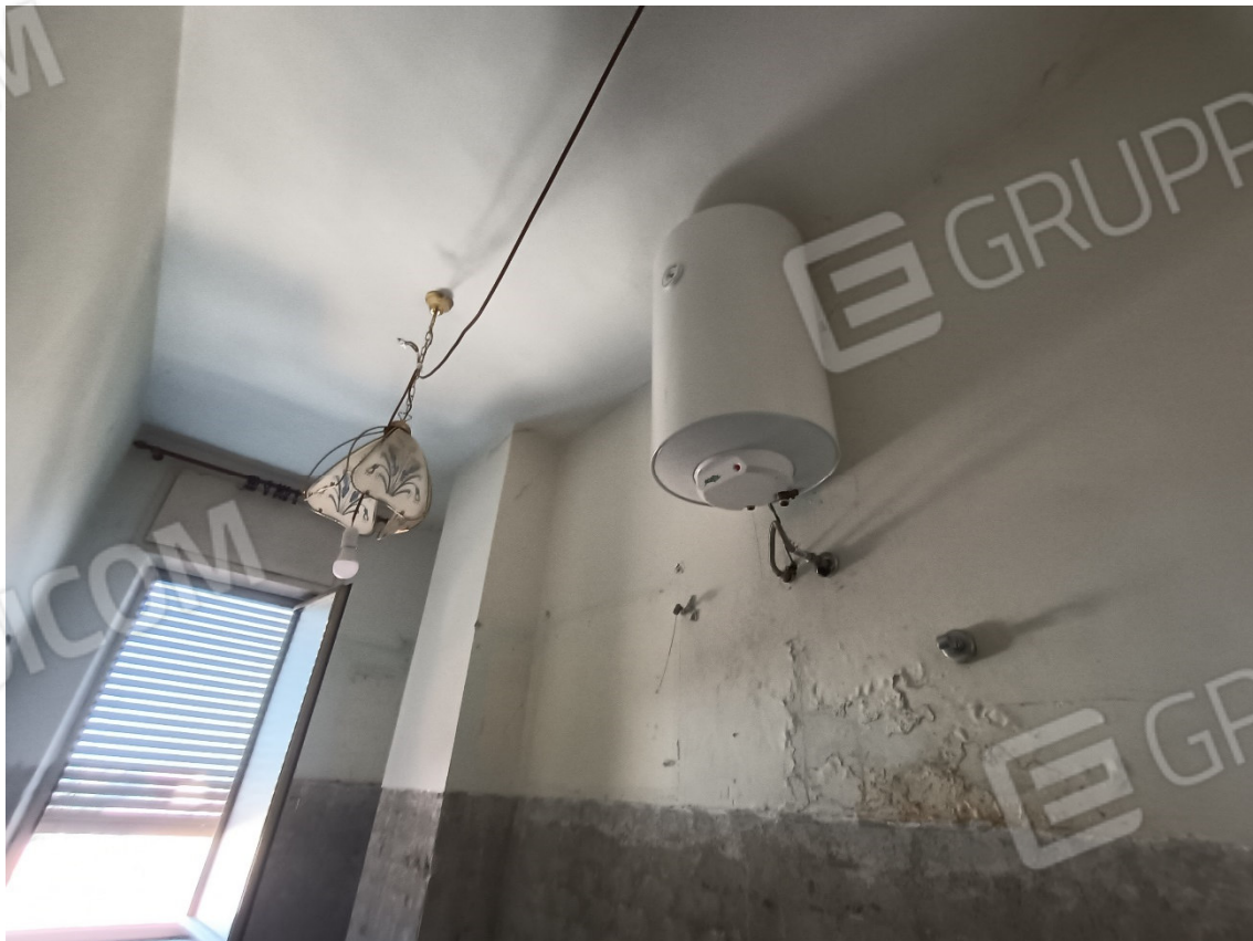
Boiler per la produzione di ACS all'interno dell'appartamento
