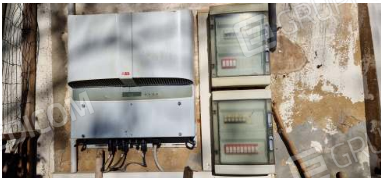
Vista del quadro elettrico
