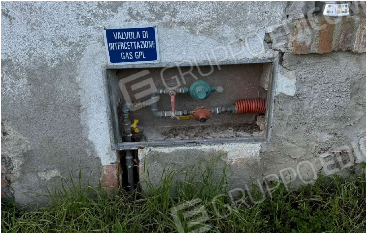
52. Valvola d'intercettazione del gas GPL.
