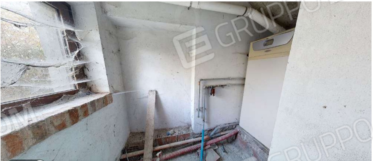
32. Sottoscala con caldaia (sub. 5-piano terra).
