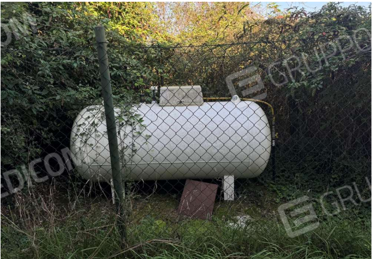
53. Recinto con bombolone del gas GPL.
