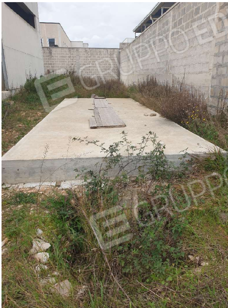
Foto 5: Vista cisterna per impianto idrico-fognante
