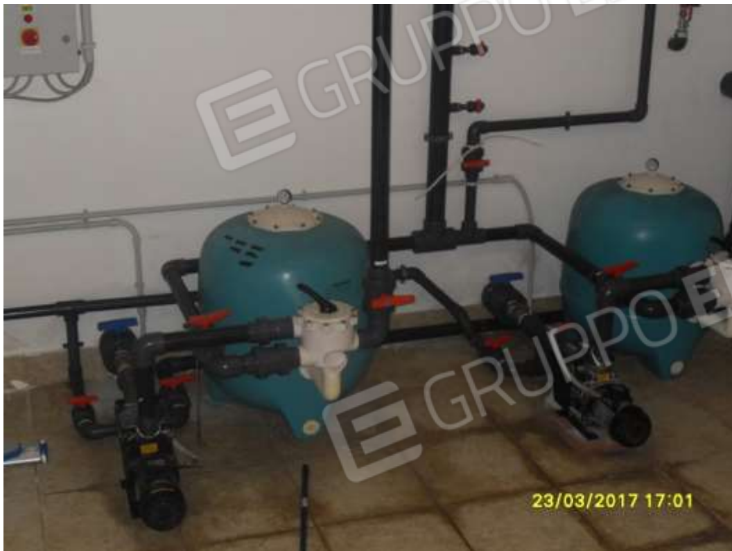
N. 70-IMPIANTI PISCINA A PIANO INTERRATO
