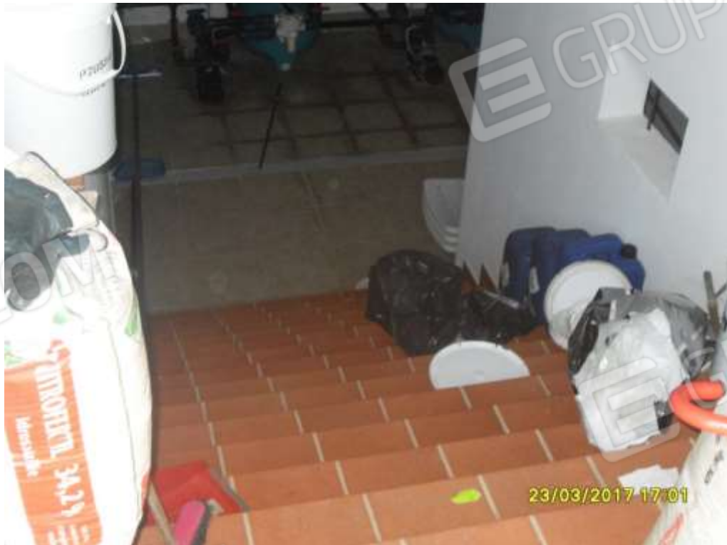
N. 69 VANO SCALA E VANO IMPIANTI PISCINA
