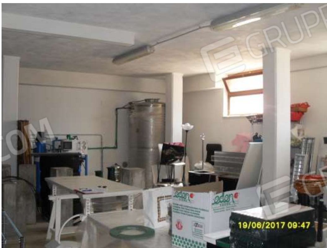
N. 56 CENTRALE IDRICA E VANO PARCHEGGIO
