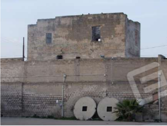
Foto 52 – Vista del prospetto orientato a Sud – Particolare muro di confine con varco d'accesso al Bene
