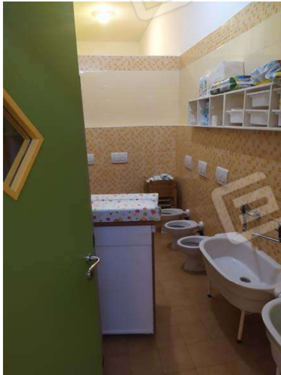
Foto 12 – servizio igienico accessibile dal corridoio (a sinistra dello spazio distributivo) funzionale all'attività svolta nell'immobile
