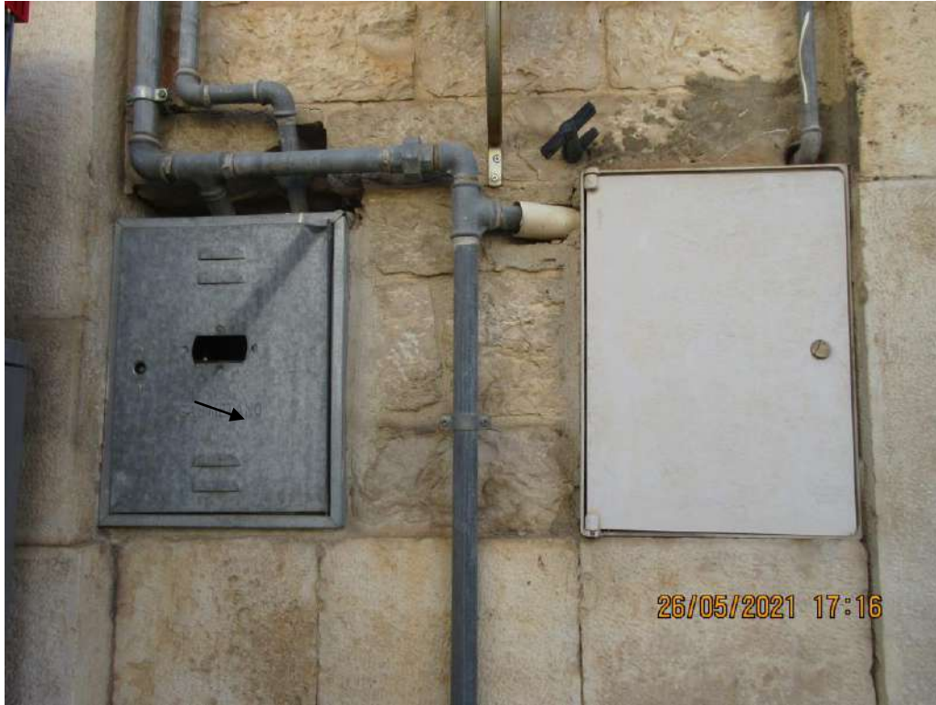
Foto n.4 Installazione contatore gas a sinistra
