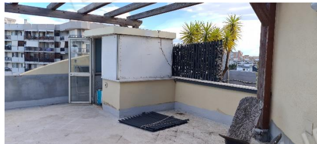
porta di accesso dalla scala a chiocciola resa interna e inglobata nell'ampliamento
