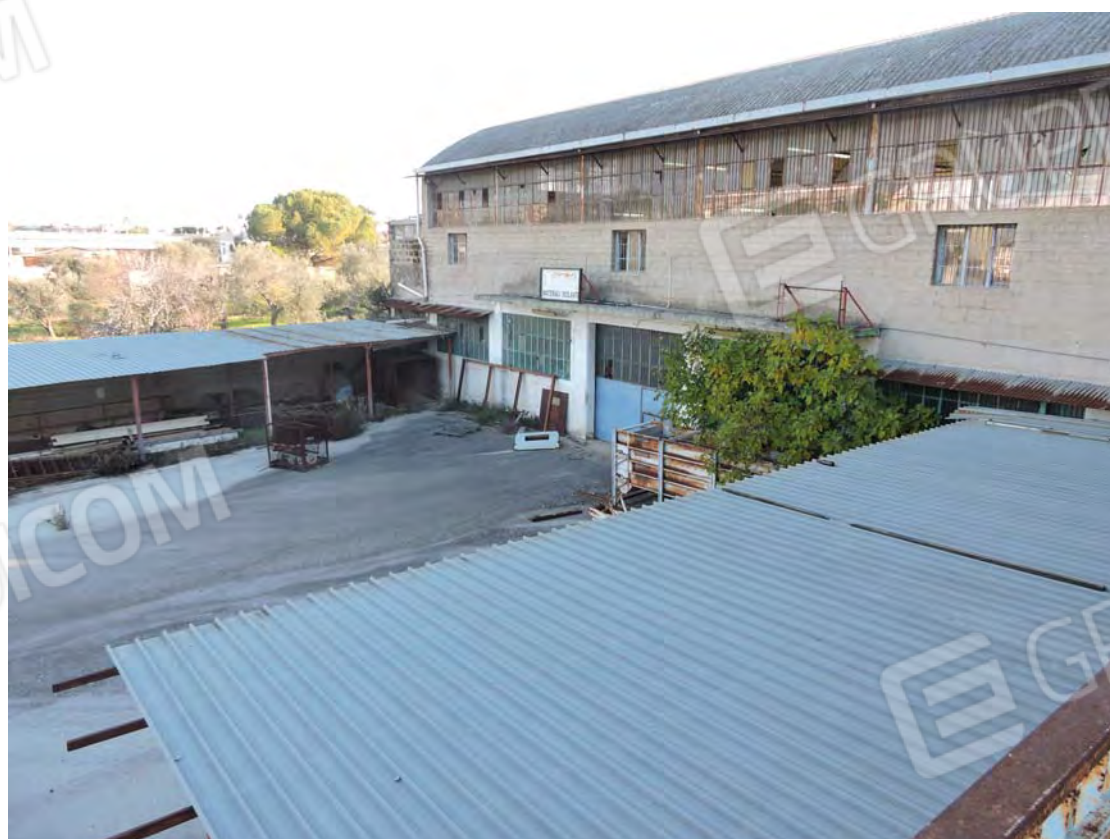
Pertinenza esterna con tettoie abusive
