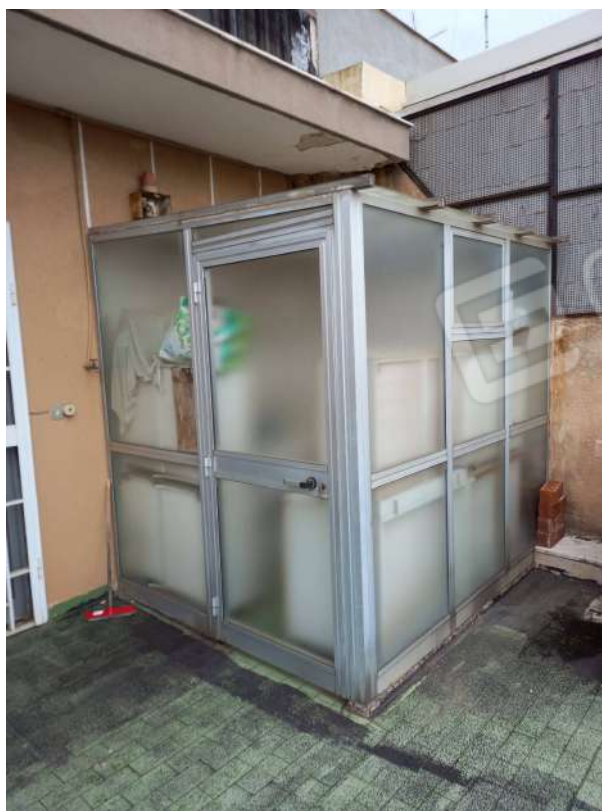
Foto n°12: Ripostiglio (abusivo) sul balcone
