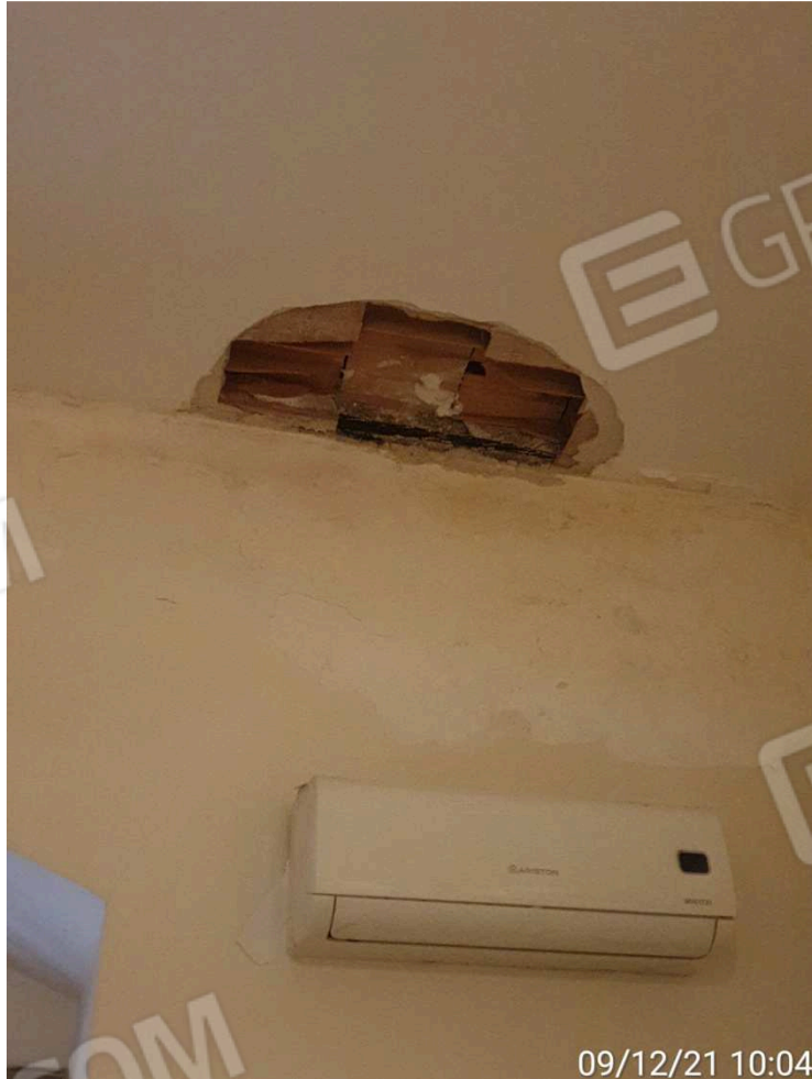
Foto 11 - FENOMENO INFILTRATIVO NELLA CUCINA DEL PRIMO PIANO
